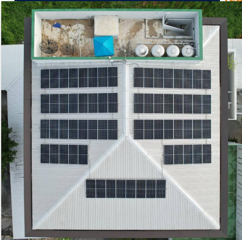
30 kWp บางนา
