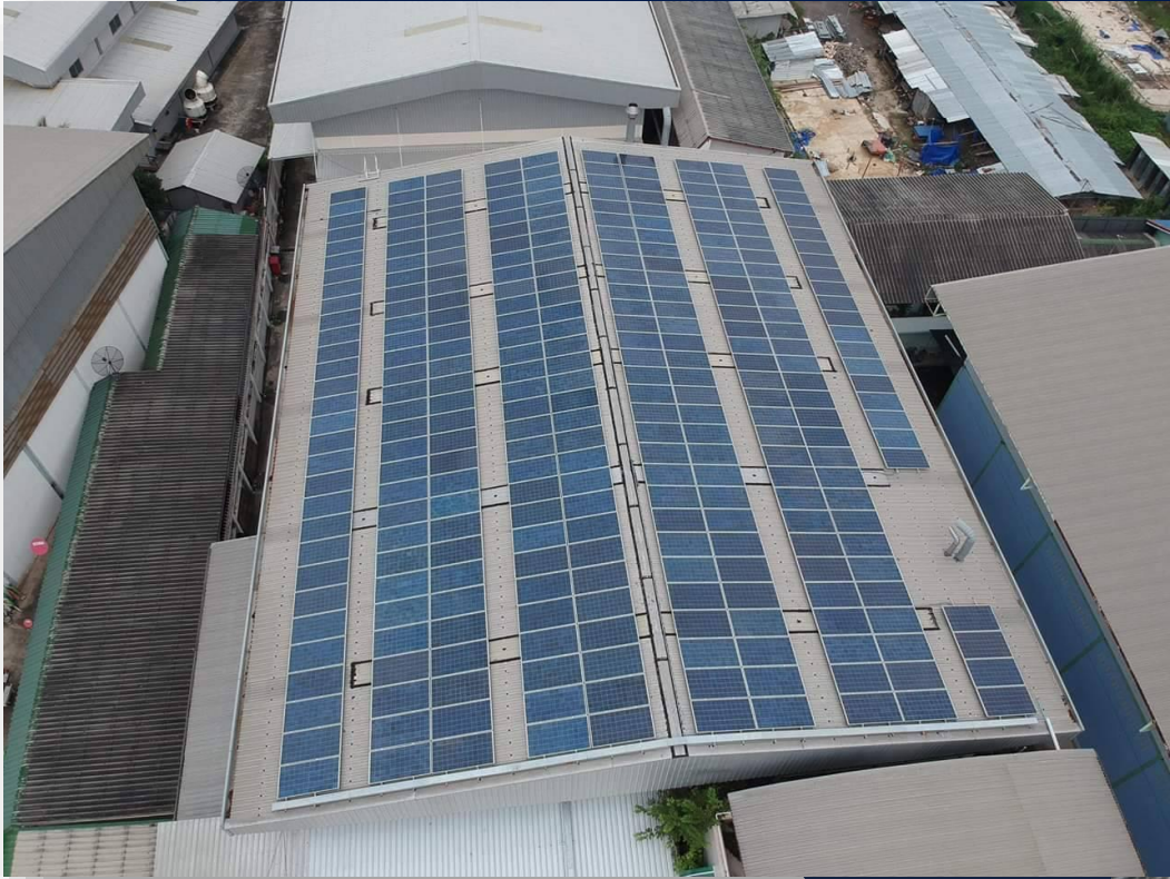
100 kWp สมุทรสาคร
