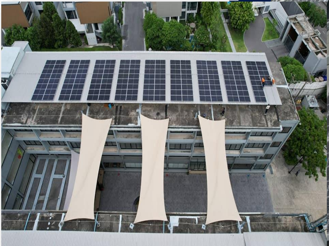
60 kWp รัชดา
